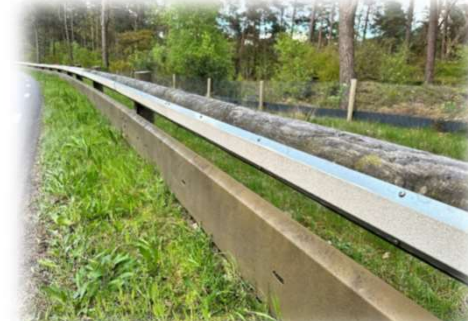
Après l'installation – de jour
